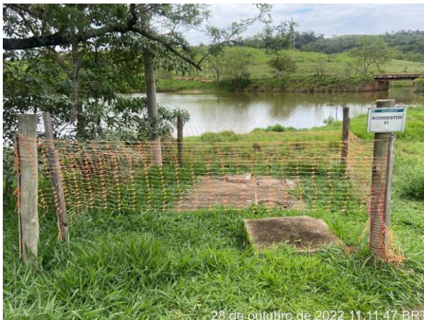
Foto 210 – Biodigestores do canteiro administrativo. (Data: 28/10/2022)
