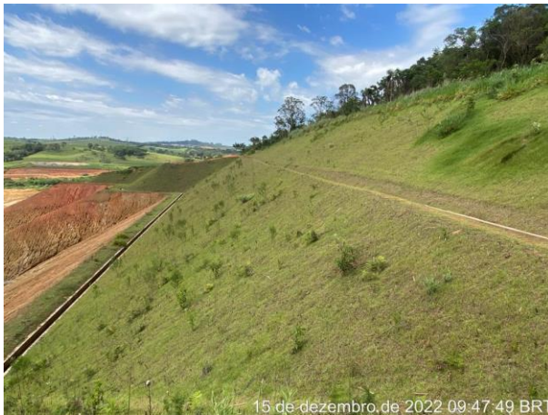
Foto 195 – Canaletas de drenagem definitiva. (Data:15/12/2022)
