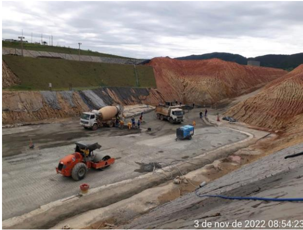
Foto 193 – Canaletas de drenagem definitiva. (Data:03/11/2022)
