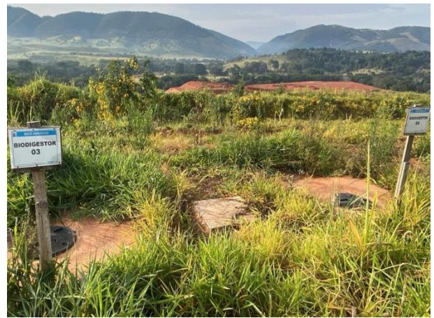
Foto 211 – Biodigestores do canteiro industrial. (Data: 27/11/2022)
