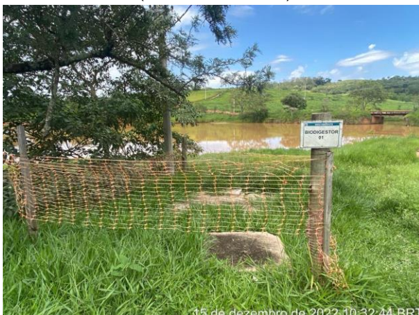
Foto 212 – Biodigestores do canteiro administrativo. (Data: 15/12/2022)
