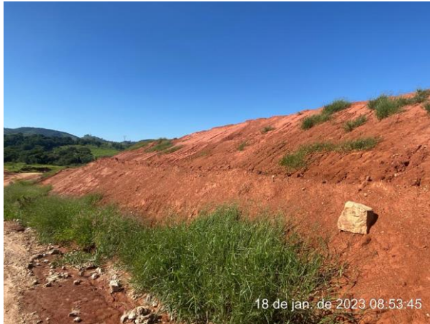
Foto 156 – Leira de proteção no entorno do bota espera com inclinação para a saída do talude. (Data: 18/01/2023)
