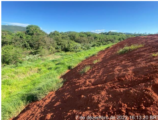
Foto 152 – Vista para leira e inclinação e direcionamento para saia do talude. (Data:07/12/2022)
