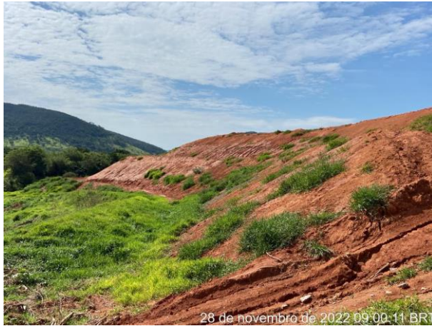
Foto 144 – Leira de proteção no entorno do bota espera com inclinação para a saída do talude. (Data: 28/11/2022)
