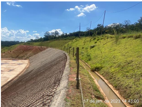
Foto 197 – Canaletas de drenagem definitiva. (Data:17/01/2023)
