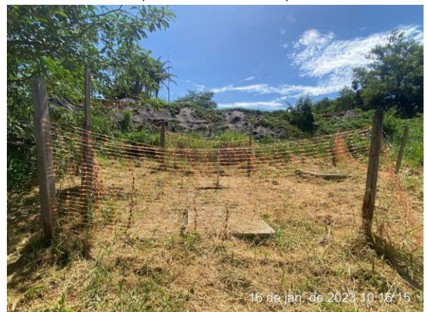
Foto 213 – Biodigestores do canteiro industrial. (Data: 16/01/2023)
