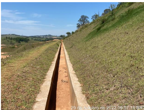
Foto 191 – Canaletas de drenagem definitiva. (Data:29/10/2022)
