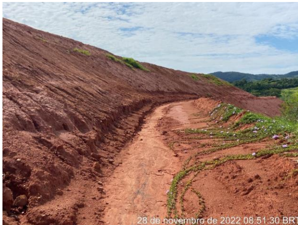
Foto 146 – Vista para leira e inclinação e direcionamento para saída do talude. (Data:28/11/2022)
